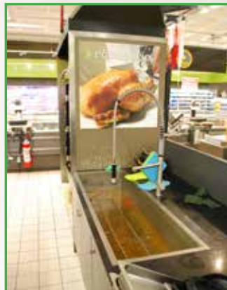
Un bac suffisamment grand permet de plonger complètement les broches de rôtisseries pour leur nettoyage et réduit les contorsions
