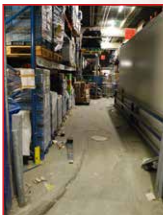
Les voies de circulations encombrées et présentant des trous augmentent le risque de chute et les vibrations
